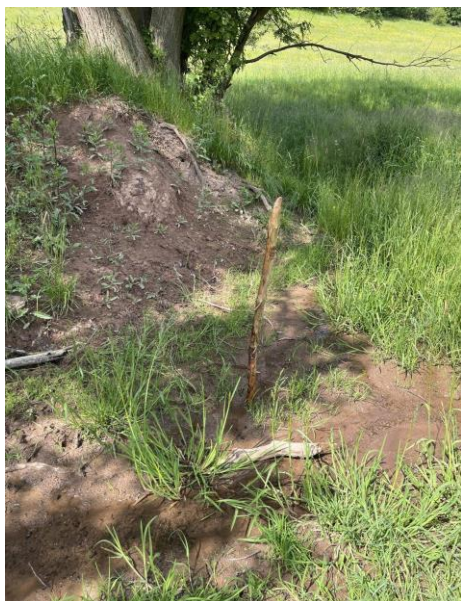
Obr. 45: Poničená hráz na toku IDVT 10183171 (Zdroj: Archiv ŽV, 2023)
